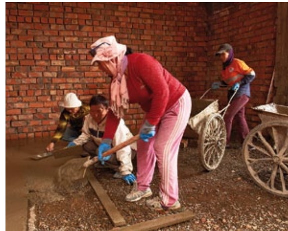
Auf dem Bau des Christlichen Gemeindezentrums in Dalandzagad in der Wüste Gobi gießen vier Frauen Estrich für den Fußboden.
